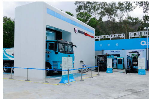
全港首座商用車換電站及行業領先電動工程機械
